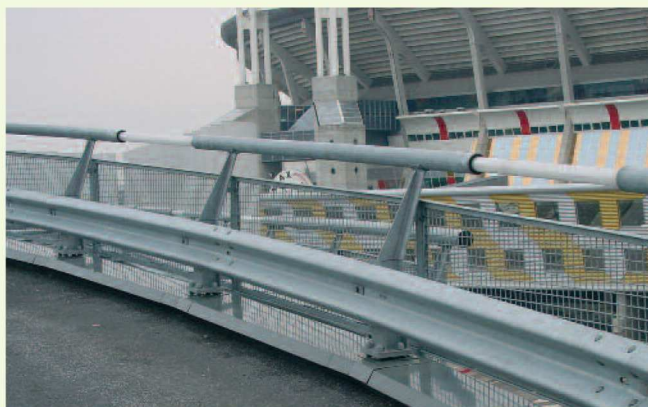
Vangrail A-profiel met hekwerk, leuning en verlichting
